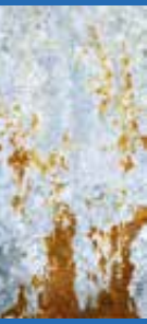
ALUZINC® après 34 semaines
