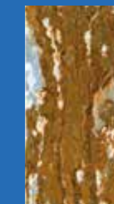
GALVANISÉ À CHAUD après 6 semaines
