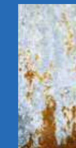
ALUZINC® après 34 semaines
